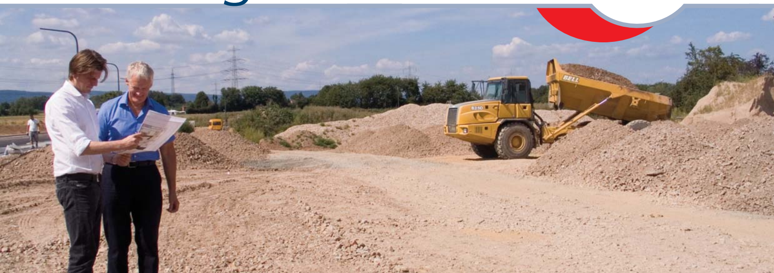
Noch wird nur Sand bewegt: Dipl.-Ing. Stefan Peters und pw°-Geschäftsführer Wolfgang Rhein begutachten vor Ort den Bauplan für die neue Werkstatt. (Foto: Regina Stappelton)
